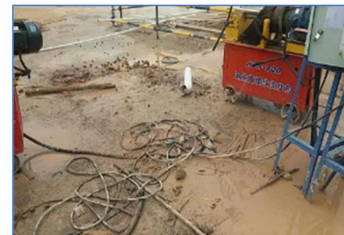
电线线缆随意拉设 ✗
